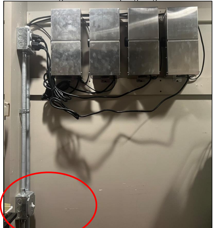
AV Closet Light Switch for Up Lighting
